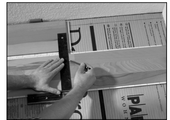
Poslední palubka první řady se s přihlédnutím k nezbytné vzdálenosti od stěny zkrátí na nezbytnou délku. Uříznutý kus palubky se použije jako začátek druhé řady.
